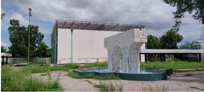
Figura 1. Estado del módulo.
