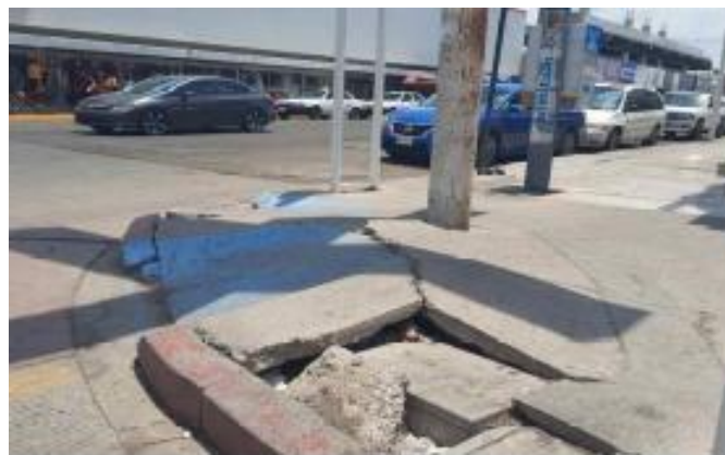
Figura 4. Rampa en malas condiciones en el centro de Cd. Obregón.
